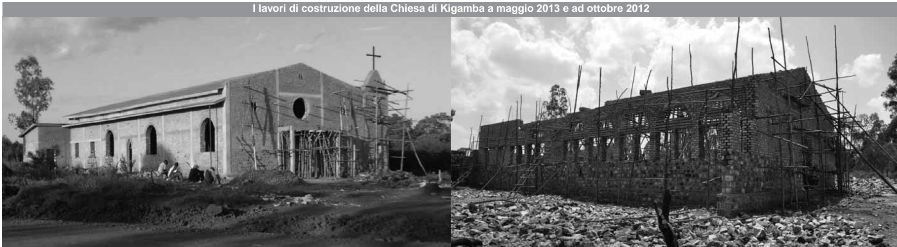
I lavori di costruzione della Chiesa di Kigamba a maggio 2013 e ad ottobre 2012
